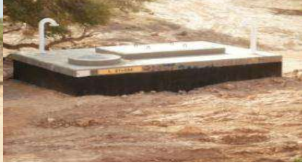
صورة (1) غرفة التغذية لمحطات الضخ.
