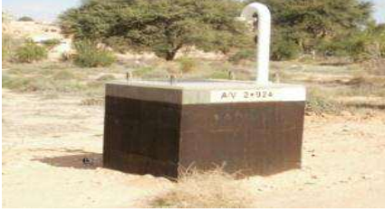
صورة (2) صمام تفريغ الهواء.
