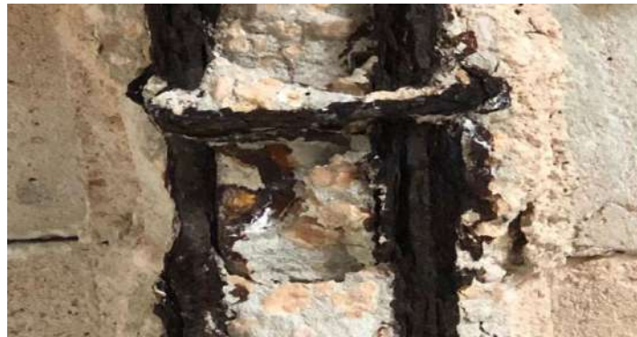
الشكل (10): تآكل حديد التسليح
