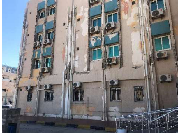
شكل (8): تدهور شديد لكل الأعمدة للواجهة الشمالية المقابلة للبحر
