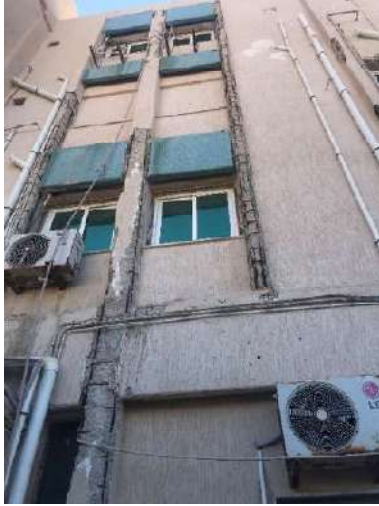
شكل (9): تدهور شديد لكل الأعمدة للواجهة الشمالية المقابلة للبحر
